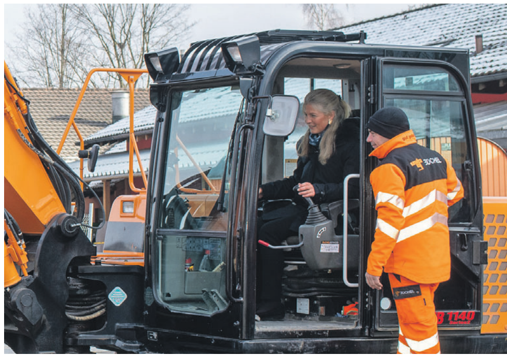
Als Hommage an ihre Grossmutter Fürstin Gina, sass Prinzessin Tatjana beim Spatenstich nach der Vertragsunterzeichnung selbst am Steuer des Baggers. (Fotos: MZ)
